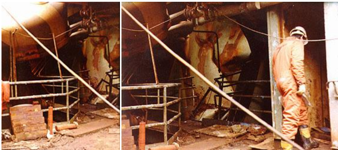
Babord siloer trykt sammen på mellomdekket.
